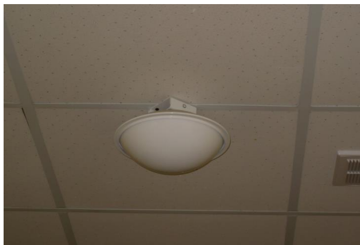
Рисунок 2 – Помещение оборудованное порошковыми пожаротушителями
